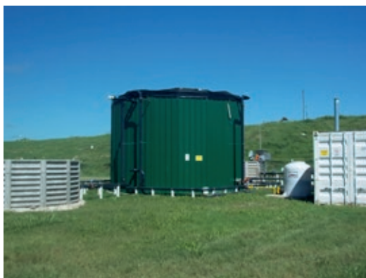
Biodigestor Complejo Ambiental
