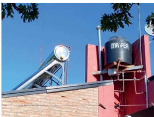
Vivienda con colectores solares
